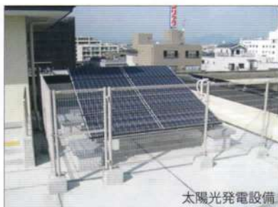
太陽光発電設備
